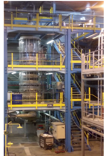
Colonne de tests de garnissages pour les unités de lavage (1 m de diamètre)
